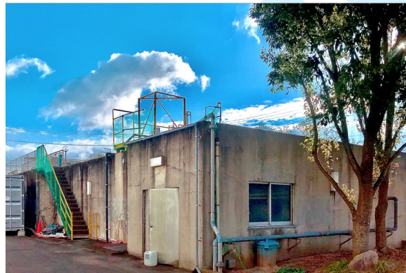
排水処理槽（外観）
