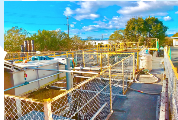
排水処理槽（上部）
